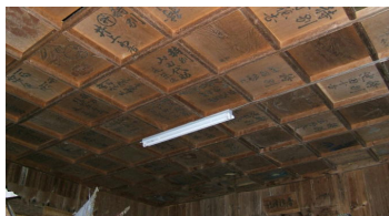
写真2. 天井絵の状況
